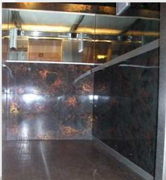
Habillages de cabine vétustes
